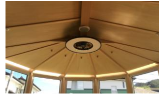
遮熱・断熱仕様天井(シナ合板)
