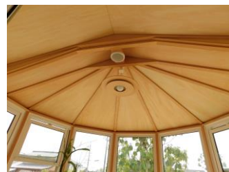
遮熱・断熱仕様天井(シナ合板)
